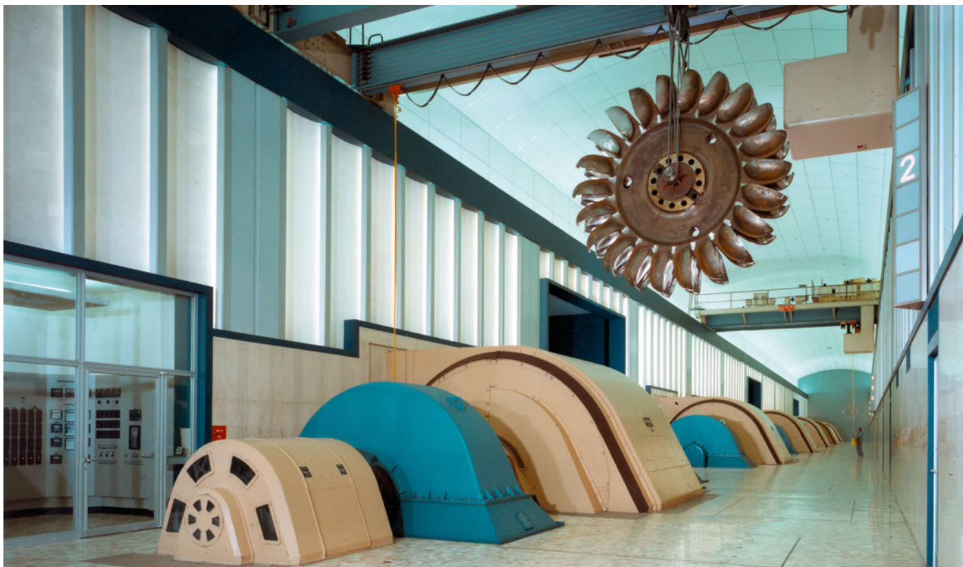
Die Kraftwerkszentrale von Nendaz. Die «nassen» Teile der Wasserkraftwerke fallen gratis an die Eigentümer zurück. Die «trockenen» müssen gekauft werden.
