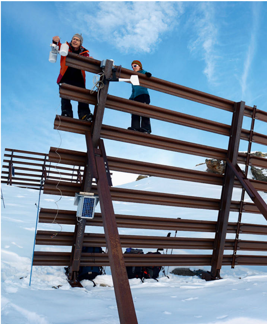
Wetterstation am Lawinverbau beim Piz Muragl.
